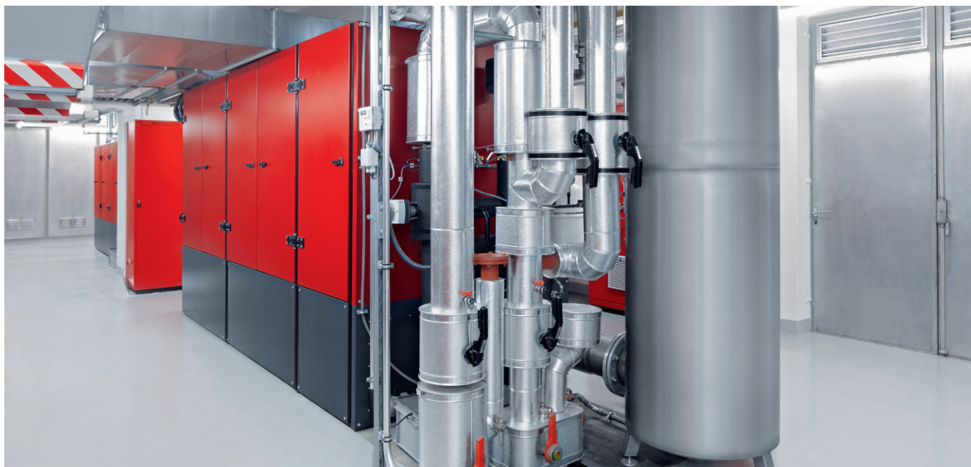
Blockheizkraftwerk (BHKW) mit einer Leistung von 240 \text{ kW}_{el} und 365 \text{ kW}_{th}
